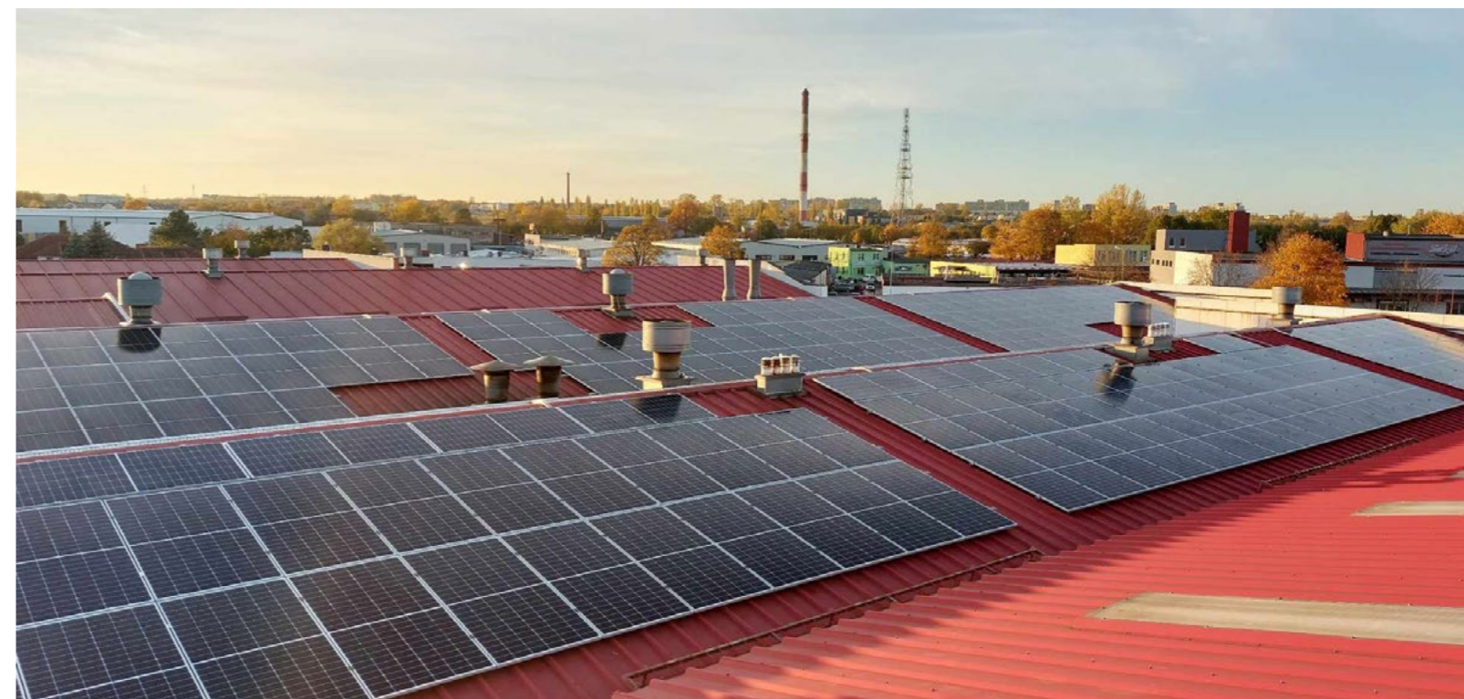
Widok instalacji PV na obiektach STAKO
